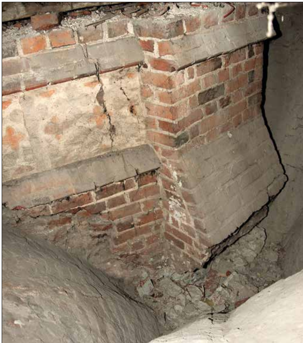
Ryc. 4. Pozostałości przypory i malowanego fryzu jednonawowego prezbiterium, zachowane ponad sklepieniem obejścia. Fot. M. Ober
