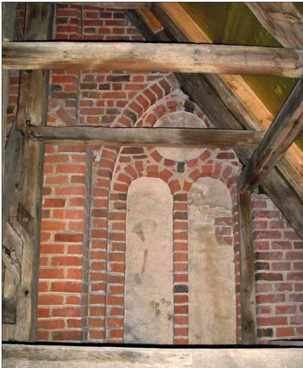
Ryc. 7. Górna część blendy w prawej dolnej części szczytu korpusu. Po lewej widoczna krawędź pogrubionej środkowej części szczytu, powyżej fragment lizeny o szfowanej krawędzi. Fot. M. Ober
